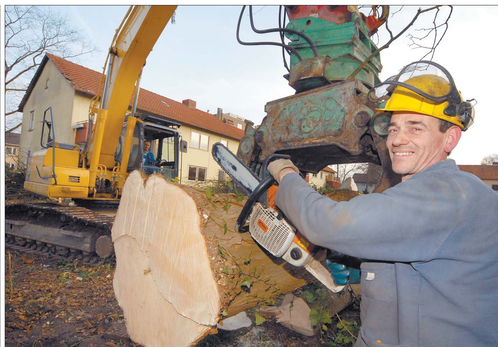
Clemens Rolf setzt die Motorsäge an einem dicken Baumstamm an. Gestern haben die ersten Vorbereitungen für den Abriss der Häuser in der Straße »Am Hügel« begonnen. Zuerst wurden Bäume und Hecken von den Arbeitern mit Motorsäge und Bagger zerlegt.
